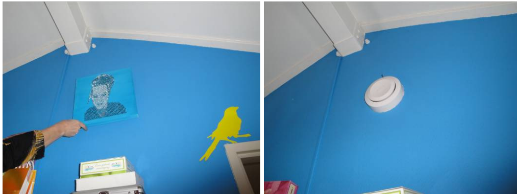
Figuur 29: Uit de bovenstaande figuren blijkt dat niet altijd voldoende voorlichting wordt gegeven over het ventilatiesysteem aan bewoners. In dit geval wordt een inblaasventiel door de bewoners gebruikt om een schilderij om te hangen. Hieruit blijkt dat de bewoners zich niet bewust zijn van het gegeven dat via het ventiel lucht wordt toegevoerd in de slaapkamer
